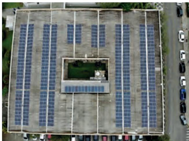
Usina no telhado do Departamento de Engenharia Elétrica
