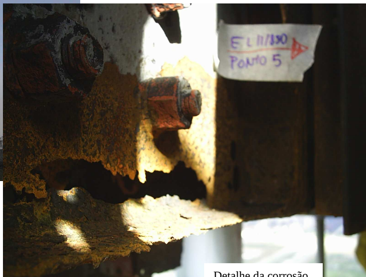
Detalhe da corrosão
